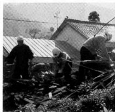
倒壊した家の片づけ
