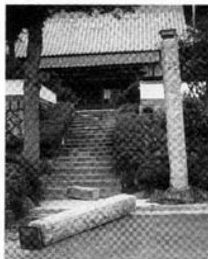
倒壊した門柱
